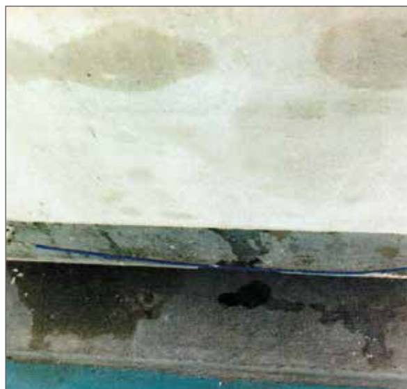
شکل ۱۰. مشاهده قطرات آب و ریزش آن
