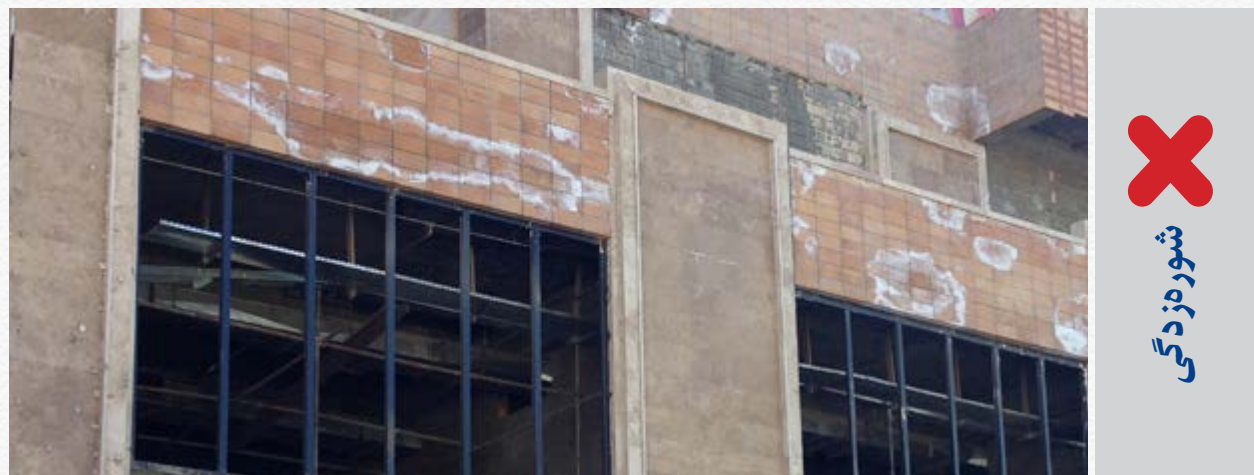
شوره زدگی در اثر متبلور شدن نمک های ناخالص درون بلوک های غیر استاندارد
